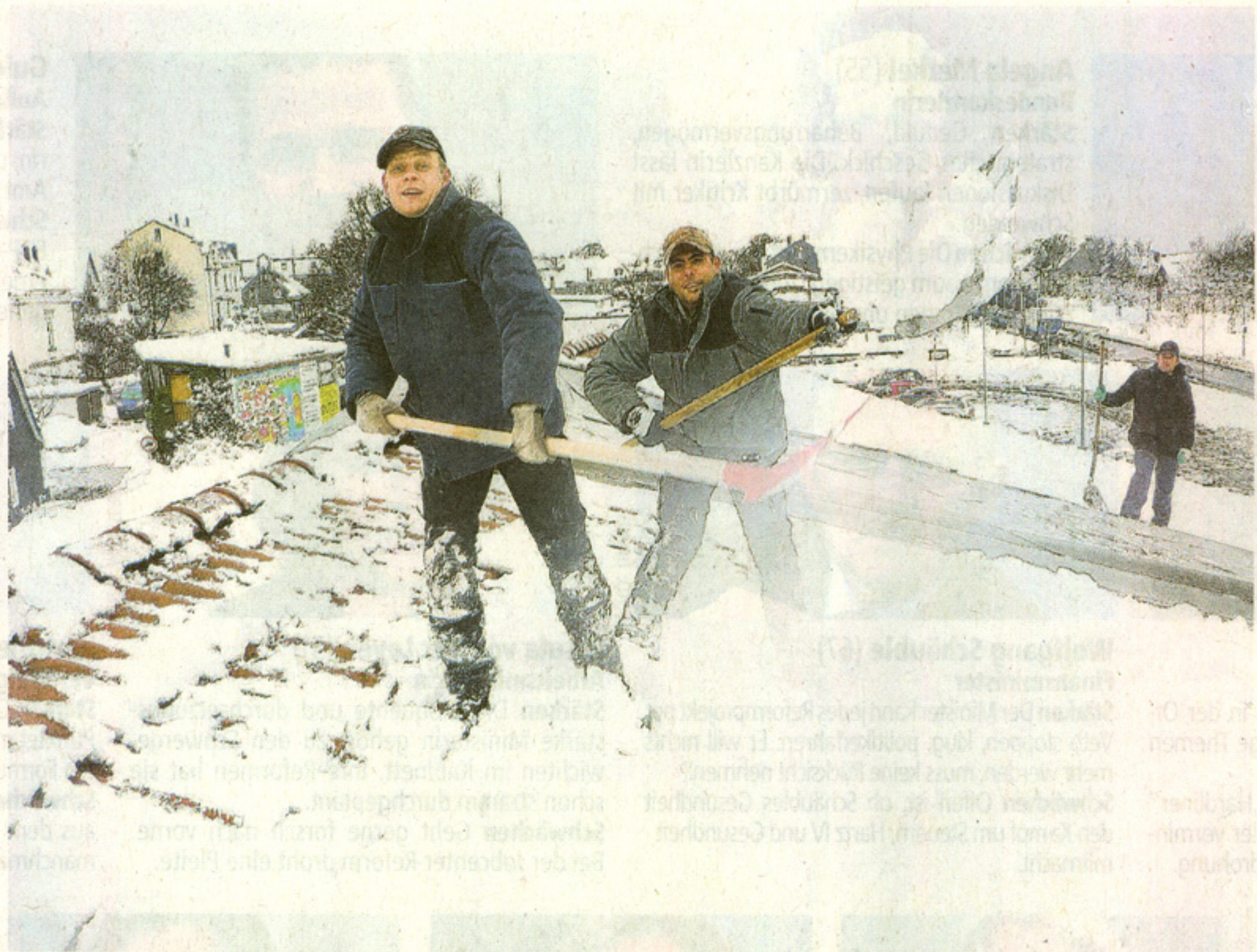
Wermelskirchen Torsten Friede und José Roca befreien das Dach eines Supermarkts von der Schneelast.
